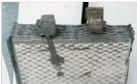
Производственный дефект: при сборке батареи оплавился свинец. Результат: короткое замыкание.
